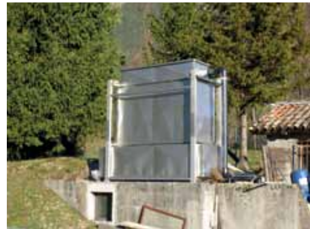
Fig. 13. Il degassatore dell'impianto di Amaro. Fig. 13. The degasser of the Amaro farm.
