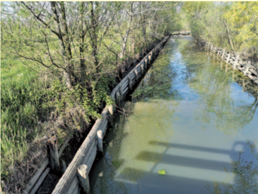
Figura 2.14 – In alto: la palizzata dopo 16 anni dalla realizzazione dell'intervento (2020). In basso: si nota lo svuotamento del materiale messo originariamente come riempimento tra le due palizzate. (Fonte: Consorzio di Bonifica dell'Emilia Centrale)
