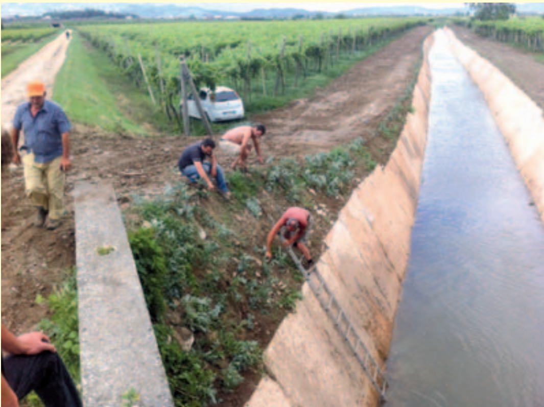
Figura 2.8 – Messa a dimora di talee di salice lungo lo Scolo Degora. La scelta di consolidare la sponda con un rivestimento in pietrame è stata dettata da situazioni contingenti inerenti il contesto locale, che non hanno permesso l'utilizzo di soluzioni a minor impatto ambientale: tale impatto è stato parzialmente compensato dalla piantumazione delle talee di salice, che permetteranno di creare un corridoio forestato in un contesto fortemente artificializzato. (Fonte: Consorzio di Bonifica Alta Pianura Veneta)
