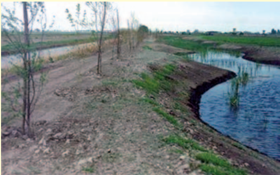
Figura 1.15 – Allargamento di sezione del Canale dei cuori intercluso mediante riduzione della pendenza delle sponde e messa a dimora di una fascia riparia lungo le rive. (Fonte: Consorzio di Bonifica Adige Euganeo)
