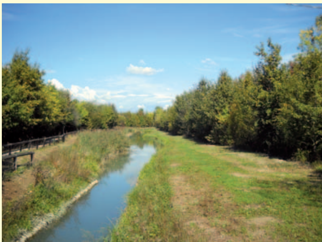
Figura 1.3 – Allargamento di sezione lungo il Collettore Acque Alte Cattal all'interno del Bosco di Mestre. Nelle due serie di immagini è mostrato il canale prima dell'intervento con le sponde in calcestruzzo, la rimozione del rivestimento spondale, l'ampliamento della sezione con diminuzione di pendenza delle sponde e il canale riqualificato dopo alcuni anni dall'intervento. (Fonte: Consorzio di Bonifica Acque Risorgive)
