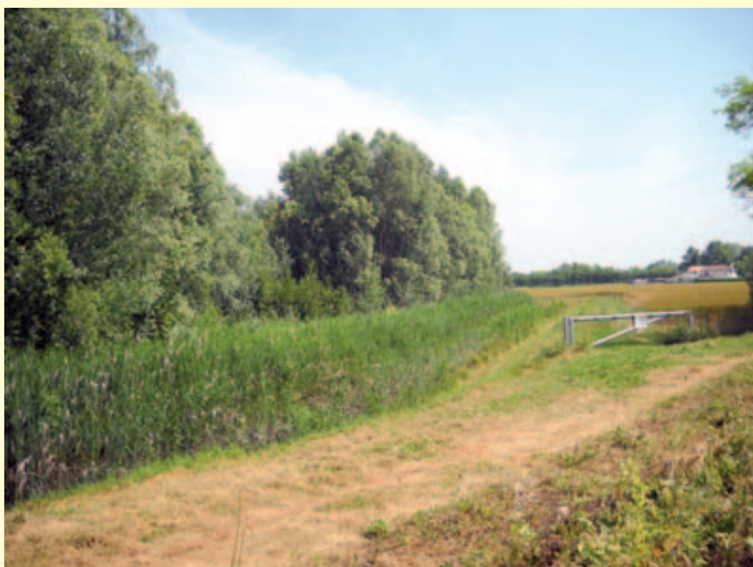
Figura 3.9 – Costruzione di una zona umida in alveo lungo la Fossa Pagana. Nella serie di immagini è possibile vedere il canale prima della realizzazione degli interventi di riqualificazione, le operazioni di allargamento e rimodellamento della sezione al fine di costruire la zona umida in alveo, la colonizzazione da parte delle piante palustri e infine la colonizzazione da parte delle specie arboree e arbustive riparie. (Fonte: Consorzio di Bonifica Acque Risorgive)
