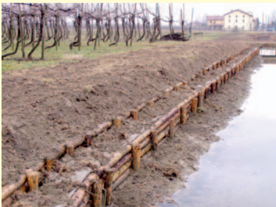
Figura 2.13 – Realizzazione di una palizzata rinverdita lungo il Canale di Budrione (Comune di Carpi – Provincia di Modena). Nelle immagini è possibile vedere in alto il canale prima dell'intervento, con le sponde erose, e a seguire la palizzata a fine lavori. (Fonte: Consorzio di Bonifica dell'Emilia Centrale)
