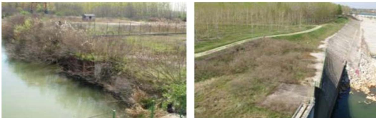
A sinistra vista sponda a monte dello sbarramento mentre a destra vista di valle.
