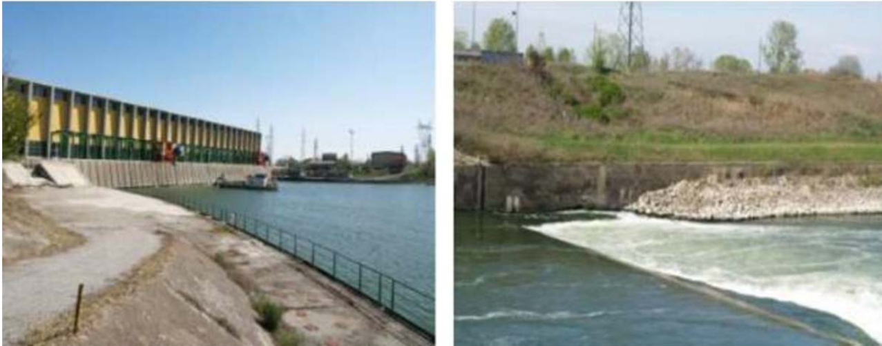
A sinistra vista sponda a monte dello sbarramento mentre a destra vista di valle.
