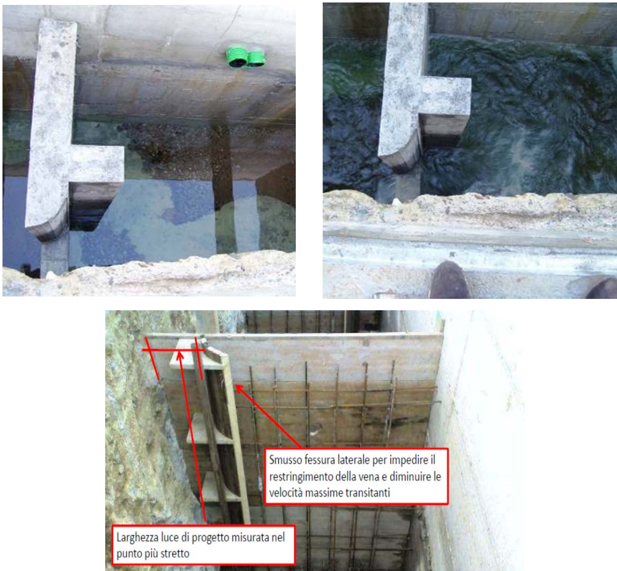
Figura 2 esempi di un setto separatore a fenditura profonda realizzato (in alto) e in fase di realizzazione
