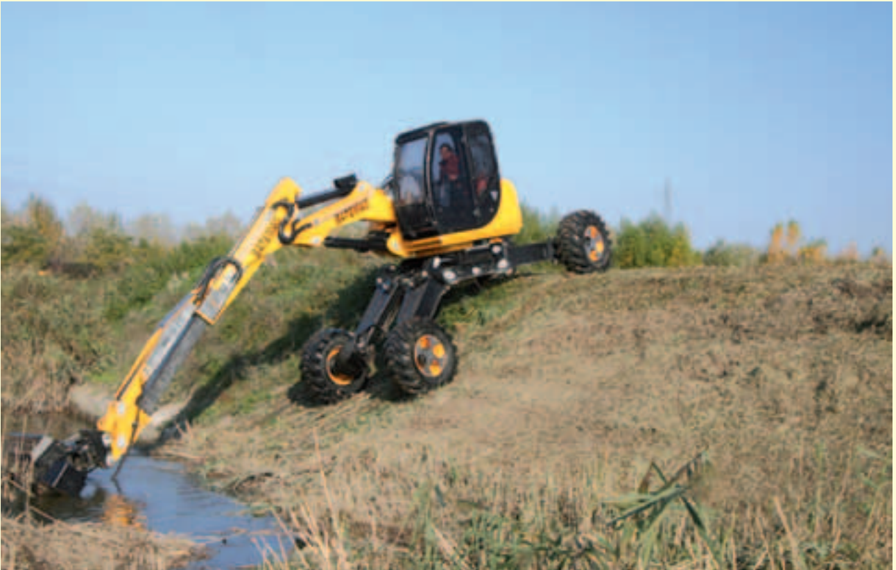
Figura 5.8 – “Ragno”, mezzo flessibile dotato di eccellenti doti di stabilità anche in situazioni dove il piano di appoggio è minimo, non regolare e variabile lungo il canale. (Fonte: Consorzio di bonifica Acque Risorgive).
