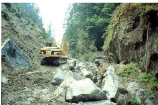
Figura 2. Torrente Cismon a valle di S. Martino di Castrozza: intervento di consolidamento al piede di una frana su un tratto d'alveo molto ripido.
