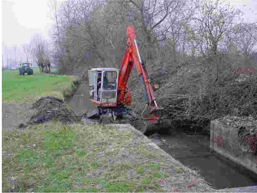
Figura 7.10: escavatore a cucchiaio, montato su un veicolo tipo “ragno”, che lavora frontalmente per lo spurgo di una sezione “critica” (Foto CBI Muzza Bassa Lodigiana).
